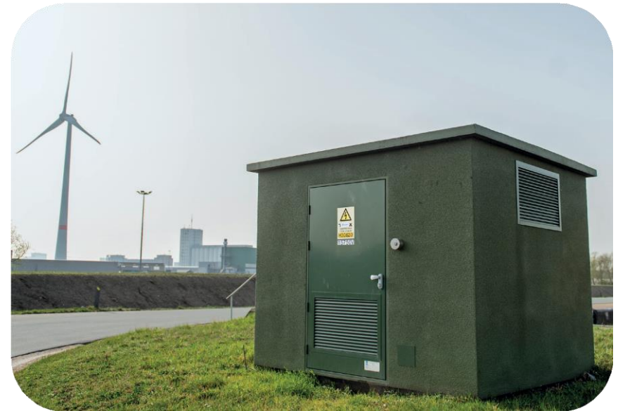
Cabine de distribution
